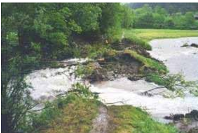
Abb. 40: Deichbruch als Folge einer Durchströmung
