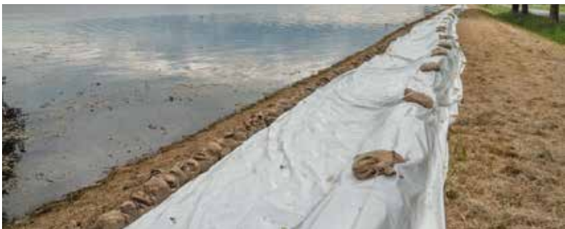
Abb. 52: Sandsackdamm (Aufkadung mit Folie)
