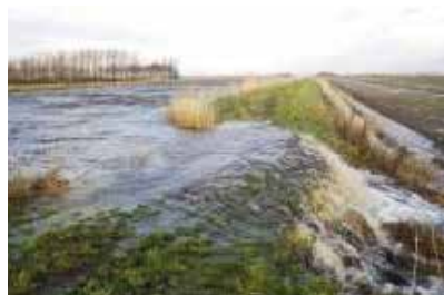
Abb. 41: Drohender Deichbruch durch Überströmen
